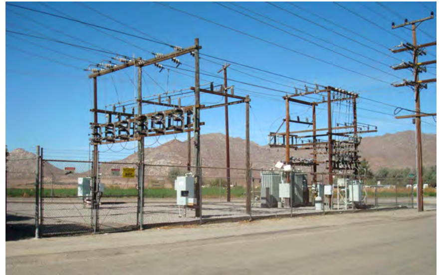
F. Nuevo Substation
